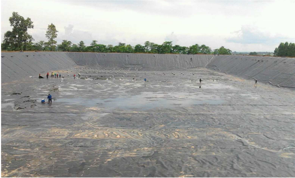
รูปที่ 11 แสดงวิธีการก่อสร้างบ่อพักน้ำหลุมรั้ง
