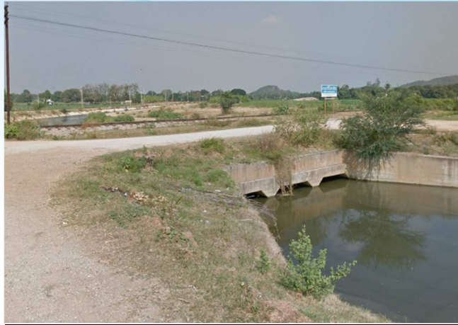
รูปที่ 17 แสดงรูปท่อลอดถนน
